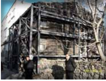
Şekil 3: Risk yönetiminin planlanmasında tek noktaya odaklanmak, ikincil ama önemli bazı risklerin göz ardı edilmesine neden olmaktadır. Yukarıda yer alan örnekte tarihi eserin yıkılmasını önlemek için yapılan takviyenin başarılı olmasına karşın, yapı geçirdiği yangın sonucu tamamen yok olmuştur (Kaynak : Gama Nurok Arşivi,2011)
